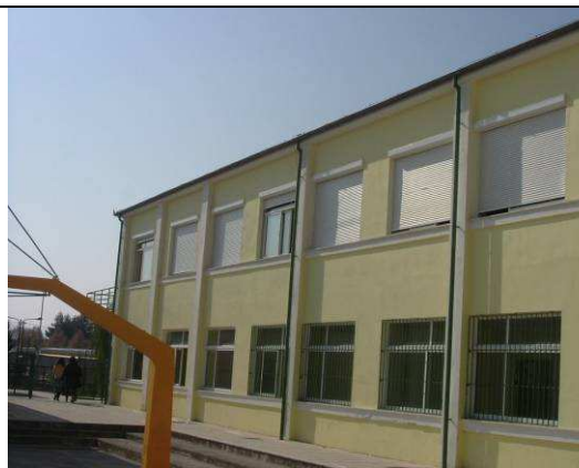
Εικόνα 1.52.Ρολά σκίαστρα στο πλευρικό διάδρομο με ανατολική έκθεση –κτήριο α. (πηγή :Προσωπικό αρχείο Α.Πασχαλίδου) (01/11/2011)
