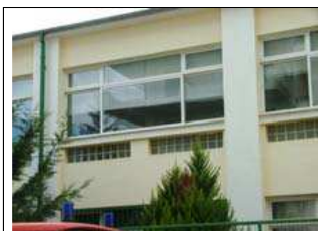
Εικόνα 1.23. Νότια πλευρά κτηρίου γ –λεπτομέρεια οριζόντιων σκίαστρων και εσωτερικών κουρτινών (πηγή : Διπλωματική ΕΑΠ –Συμμεωνίδου Παναγιώτα,2008)
